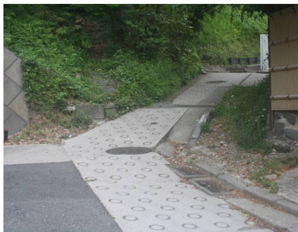
戸塚町 4972 付近路面・側溝の状況
