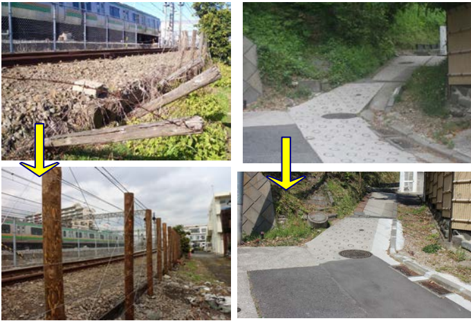
上倉田町381番地付近JR線踏敷柵の老朽・破損が整備されました。(写真左) 戸塚町4972番地付近の路面・側溝が改修されました。(右)
