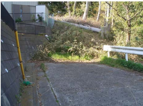
影取町 道路への土砂流出現場
