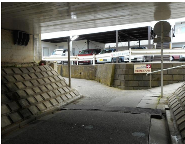
対策前 隧道西側出口の状況 (7月19日撮影)
