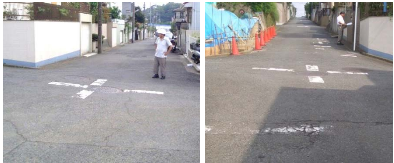
舞岡台団地内の道路舗装の傷み状況 (2014年7月21日撮影)
