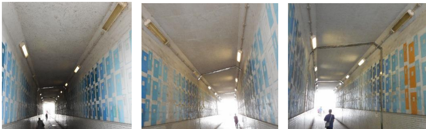
上倉田隧道・照明器具故障の状況（写真左から器具No.16、13・11、5）（撮影 10 月 18 日）
